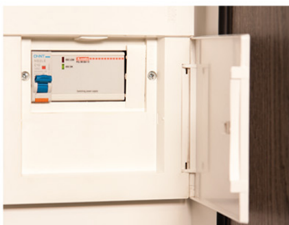
Particolare quadro elettrico Detail electric panel
